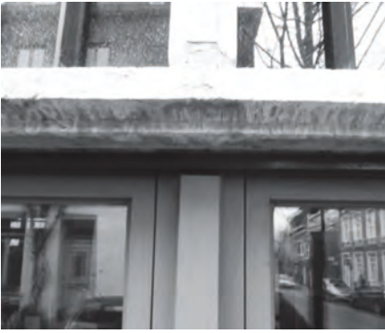
Afb. 4. Steunijzer (donker onder de witsteen-tussendorpel) boven een van de hoekwinkeldeuren in Goudstraat 12 (foto 2015).
