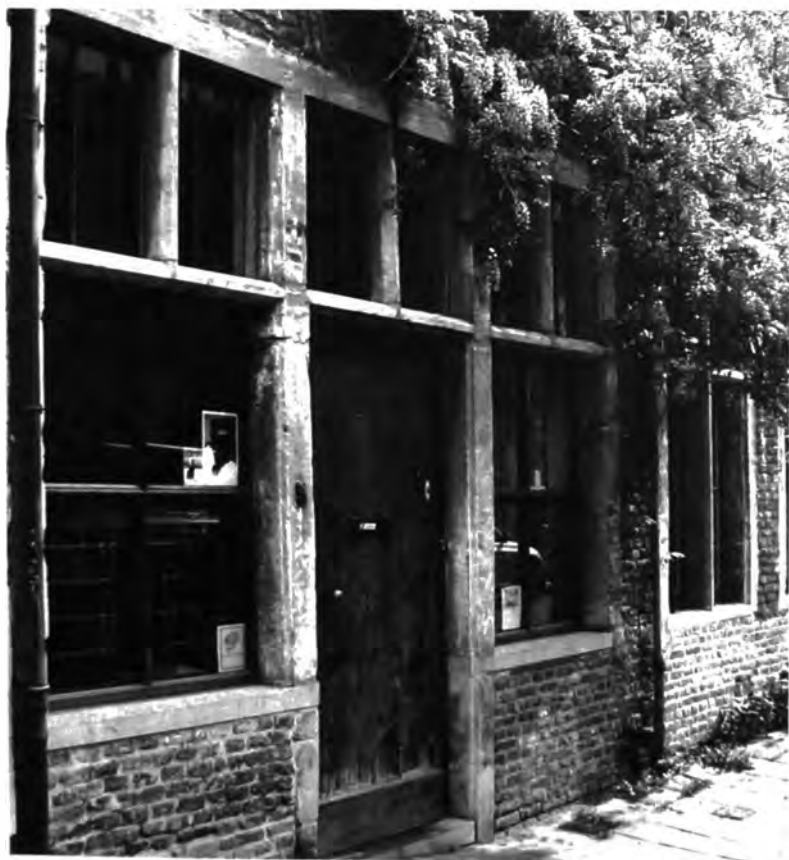
Afb. 21. Abrahamstraat (foto 2015). Zachte restauratie met behoud van de originele kolommen. Drielichtvensters naast de winkeldeur. Een kruisvenster verderop.
