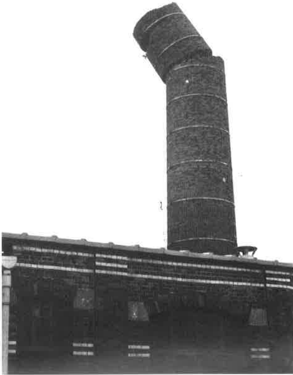
Afbraak van de laatste der twee schouwen waarvan tot 1959 naast de potbakkerij een gedeelte is blijven staan
