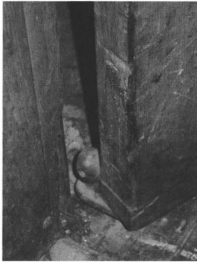
Afbeelding 22 In de empireperiode doet een nieuw scharniertype zijn intreden. Op deze afbeelding is de speun onderaan de deur te zien die met een vast plaatje zit ingewerkt in de vloerplanken. De regelschroef maakt het mogelijk om de deur, indien nodig, hoger op te schroeven (Eigen foto, maart 2006)
