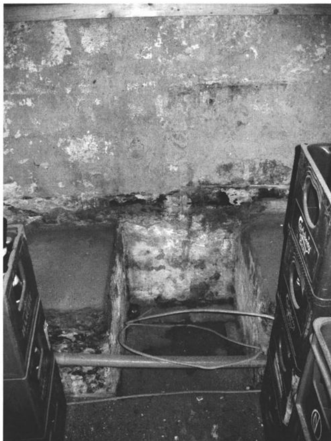
Afbeelding 13 In de dikte van de zuidelijke zijmuur staan twee verdiepte vensterbanken die volledig uit breuksteen werden vervaardigd. Ze zijn respectievelijk 47 centimeter (vooraanzicht, links) en 54 centimeter (vooraanzicht, rechts) breed. De muurplint in breuksteen is 48 centimeter hoog en draagt een onderdorpel in breuksteen van gemiddeld 10 centimeter hoog (Eigen foto, maart 2006)
