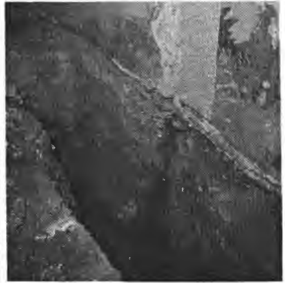
Afb. 25 — O.L.V.-kapel, resten van ro- maanse fundering met breuk in metselwerk
