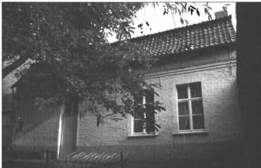
Afbeelding 3: Voorgevel van de oude pastorie in classicerende barok, aangepast in de periode 1736-1738 (Foto: Katrijn Depuydt).
