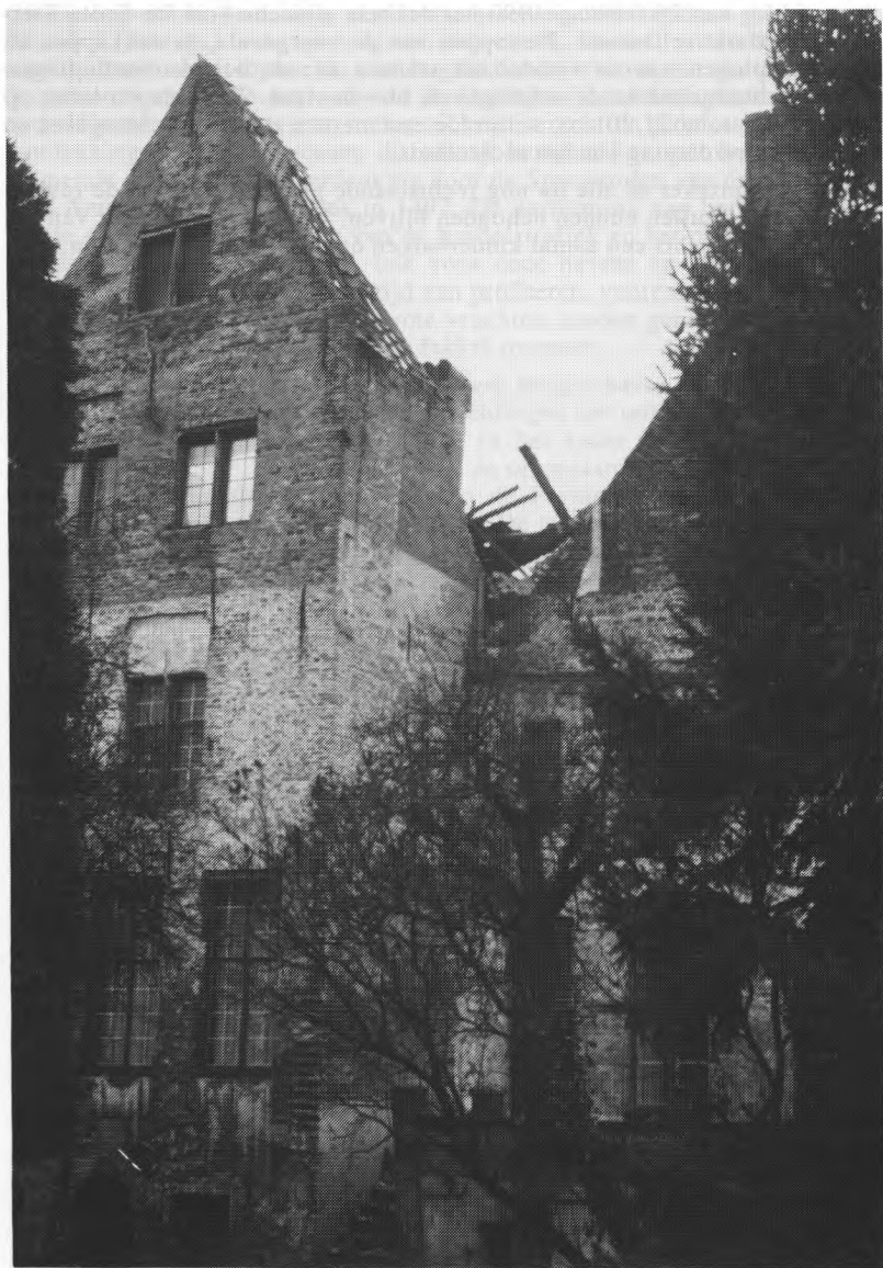
Damme. De Grote Sterre, de achtergevel op 28 februari 1990, enkele uren vóór de instorting (foto L. Devliegher).
