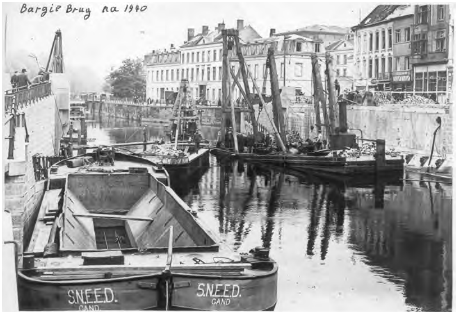
Afb. 6. De gedynamiteerde brug wordt opgeruimd en vervangen door een noodbrug (fotocollectie DSMG). Bemerkt de pontons met hoge installaties om palen te heien.
