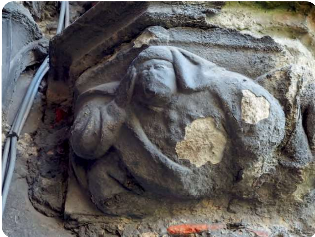
Afb. 3. Een imposante figuur in afbladderende witsteen als kraagsteen in de pandgang van de Sint-Baafsabdij. Oei, oei, wat overkomt me hier? Met reden bezorgd kijkend: recent hebben nijvere elektriciens - kabeltrekkers hem maar net kunnen ontzien. Sinds het maken van de foto (2021) werden de kabels iets verderaf, maar nog steeds goed zichtbaar, herbevestigd. De figuur lijkt een mondkapje te dragen, maar dat is gezichtsbedrog.
