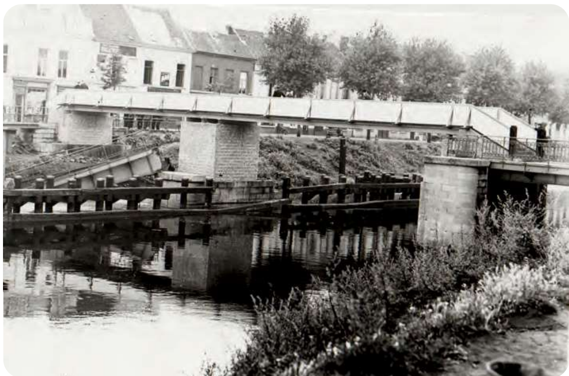
Afb. 9. Noodconstructie van het Hamerbrugje na de dynamitering in 1940. Links ligt nog een groot stuk van de gedynamiteerde oude brug in het water. Bemerkt de trapjes! Uit: Beeldarchief in DSMG.
