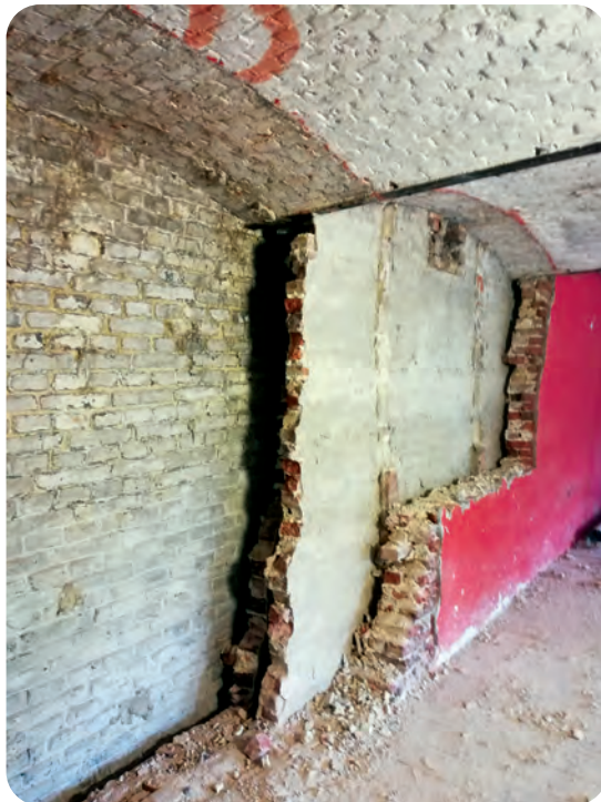
Afb. 9. Driedubbele zuidmuur (kant naar de Keizerpoort toe), met goed isolerende dubbele spouw (foto A. Brysse, 2021).
