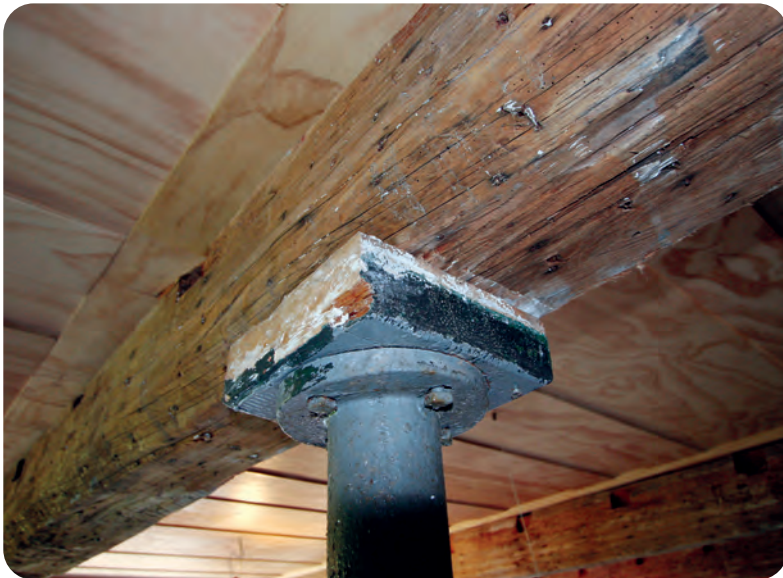
Afb. 6. Gerestaureerde gietijzeren kolom met kleine dekplaat (foto A. Brysse, 2021).
