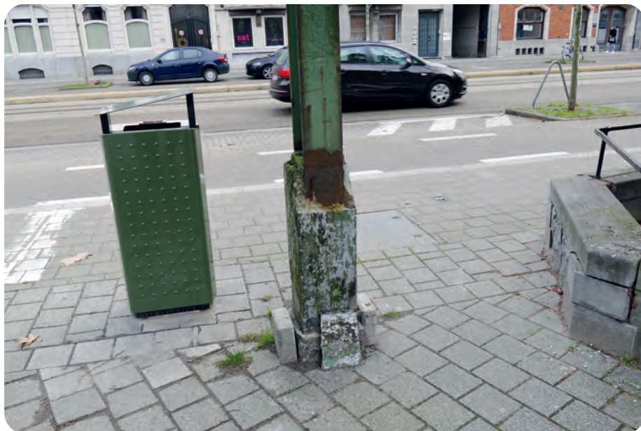
Afb. 1. Oppervlakkig aangetaste paalvoet. Toestand op 3 januari 2019. In de achtergrond de Kon. Albertlaan.
