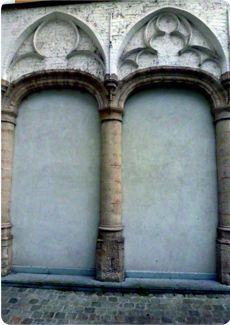
Afb. 10. Twee van de acht gerestaureerde korboggen, zichtbaar op de binnentuin, bekroond door origineel al toegewerkte spitsboogfriezen met maaswerk. In 2019 een fietsenstalling met klasse (foto 2019).
