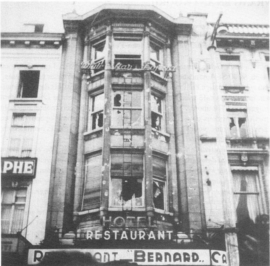
Wilsonplein. De beschoten gevel van het Restaurant Bernard. (Uit Gent , september '44 van J-P. Marchal)
