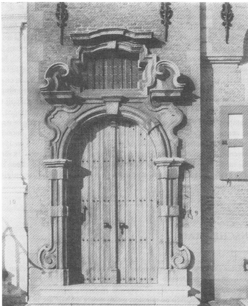
Deuromlijsting van een huis dat in 1892 in de St-Kathelijnestraat gesloopt werd en nu geïncorporeerd is in het huis "De Swaene" op de Korenlei.
