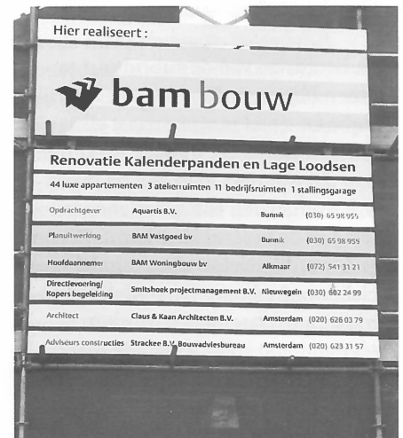
Recent verdwenen vrijplaats maakt plaats voor appartementen in het entrepotdok in Amsterdam. (Foto Maurice Tuunter)
