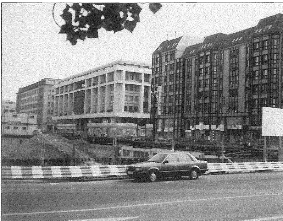
De bouwwerkzaamheden maken de Friedrichstraße voor lange tijd slecht bereikbaar. Foto: auteur
